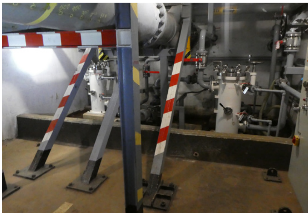
Nuevo sistema de limpieza de cambiadores en CNA
