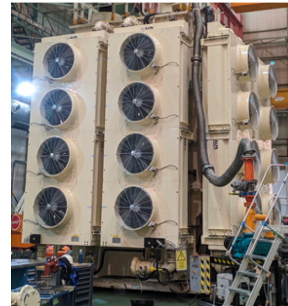
En CN Trillo se ha completado la fabricación de un nuevo transformador principal
